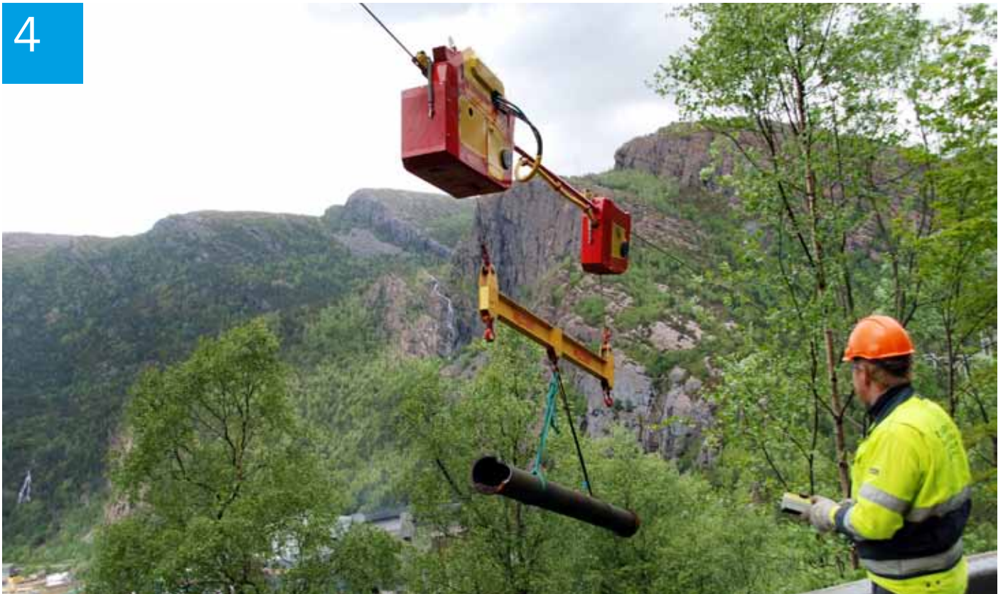
LØPEKATT: Gamle rør fraktes ut med taubanen. Banen styres med fjernkontroll av operatøren, som står ute i terrenget. Denne nærheten øker sikkerheten for mannskapene og gir stor fleksibilitet i montasjearbeidet.
