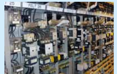
BRYTERE: Etter to døgn arbeid var elektro-utstyret byttet, og kalksalpeterfabrikken kunne kjøres opp igjen.
