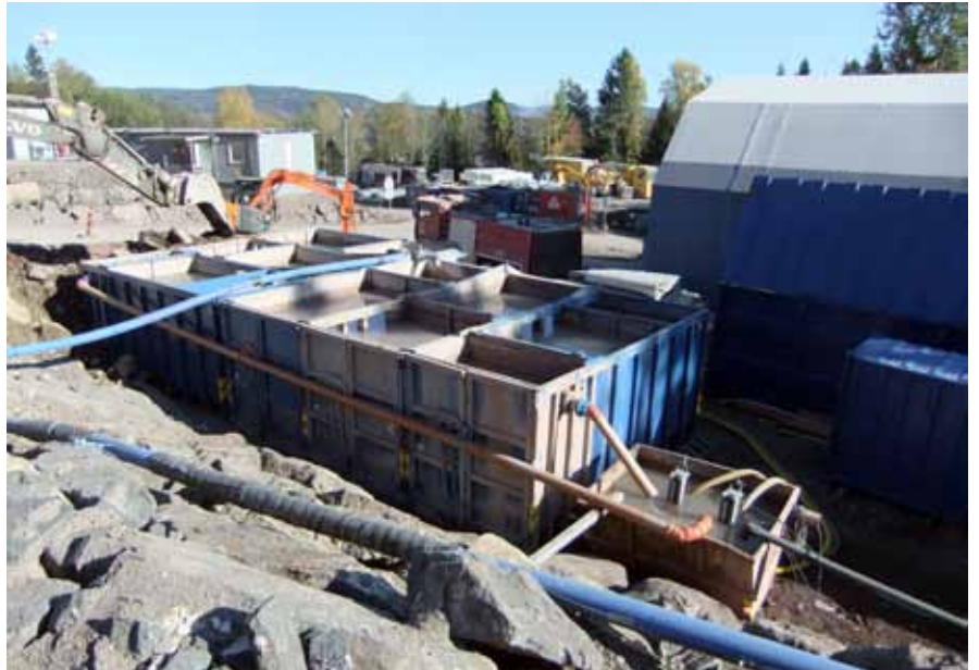
SEDIMENTERINGSANLEGG: Slam skilles fra borevannet i sedimenteringsanlegget.
